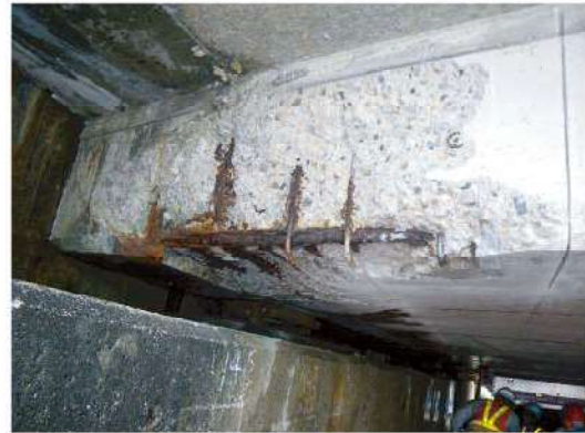
塩害により劣化した床版
