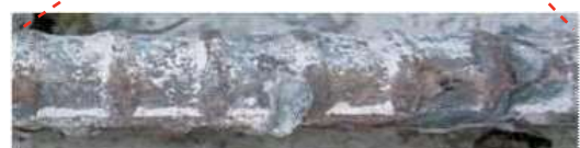
ビルテクト-100E塗布前の鉄筋腐食状況
