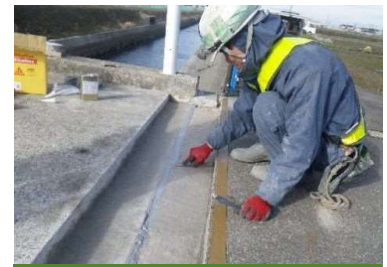
③二次止水処理
