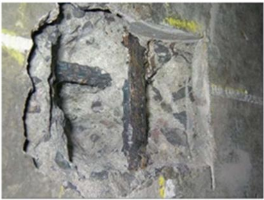
【はつり出した鉄筋の腐食状況】
