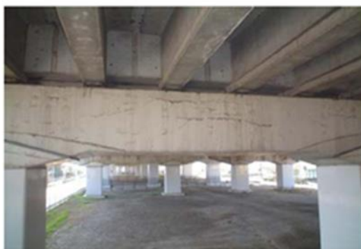
【主鉄筋方向のひび割れ】
