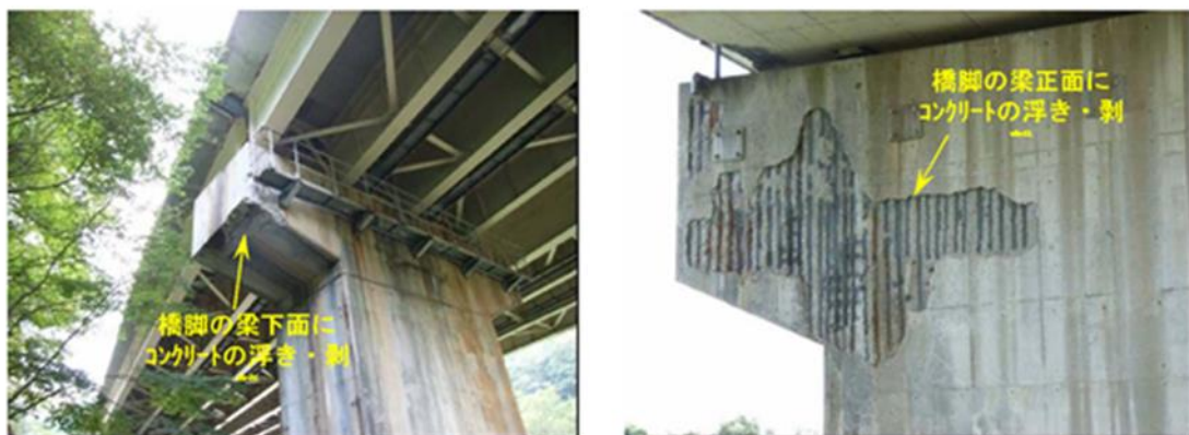
【RC 橋脚の浮き・剥離】
