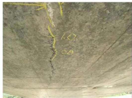
【PC 鋼材方向のひび割れ】
