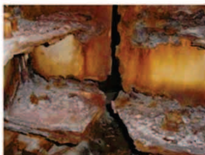
【劣化グレードの事例】
