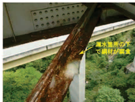
【RC床版からの漏水による対傾構の腐食】
