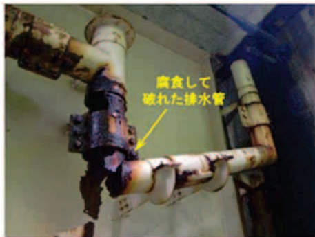
【腐食して破れた排水管】
