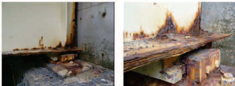
【桁端部の塩害劣化】
