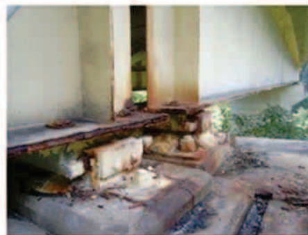
【劣化した伸縮継手の下の桁端部の腐食】
