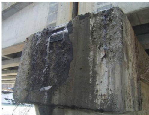
【一般的な橋面排水が 流下する箇所の凍害による劣化事例】
