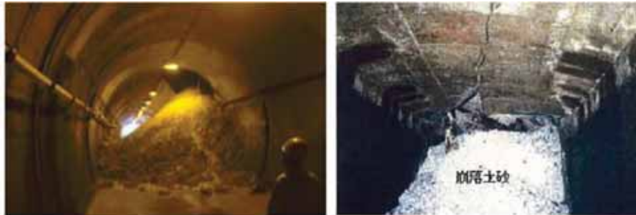
愛知県トンネル崩落事故状況 NHKスペシャル 「調査報告日本のインフラが危ない」より
