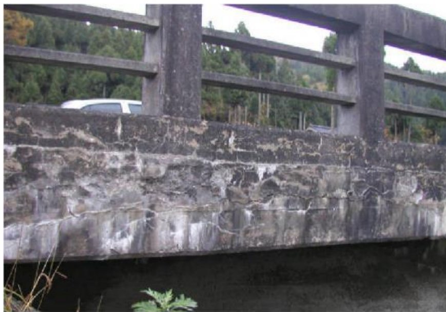
【一般的な路面排水の影響を受ける箇所でのアルカリシリカ反応による劣化事例】
