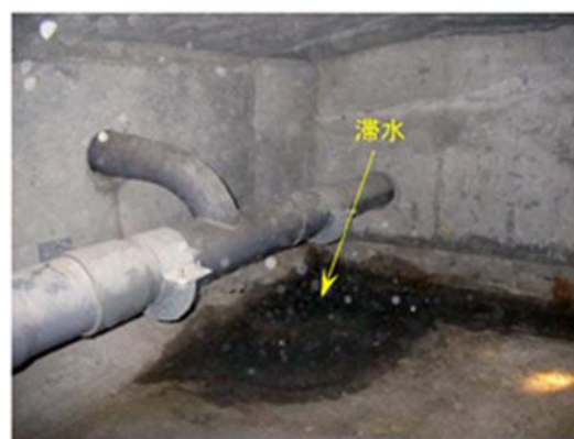
【水染み上の箱桁内部】
