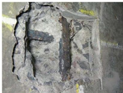
【はつり出した鉄筋の腐食状況】
