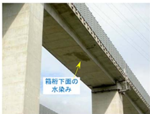
【箱桁下面の水染み】
