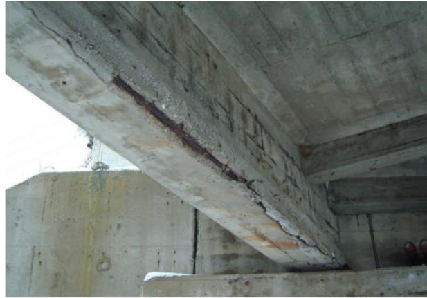
【桁の下面における塩害による劣化事例】
