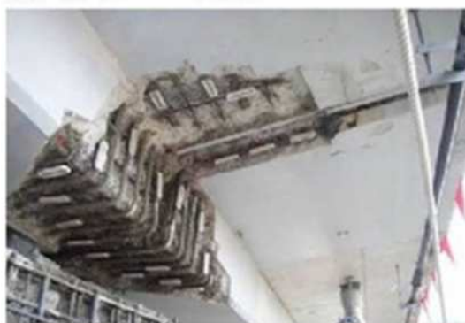
犠牲陽極材による延命化
