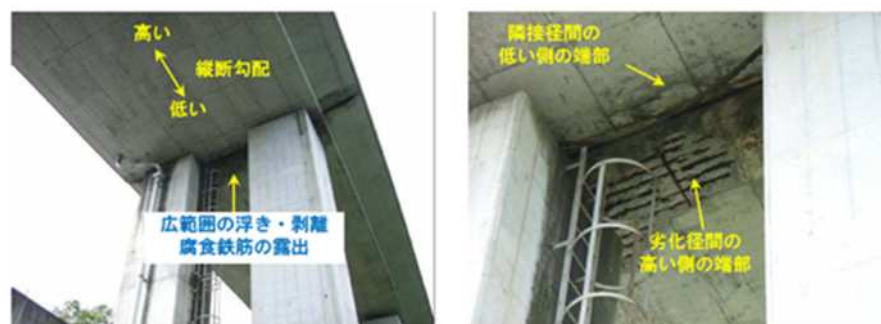
【縦断勾配の高い側の端部で劣化が顕在化】
