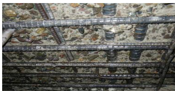
写真-5 はつり完了後の凹凸状況
