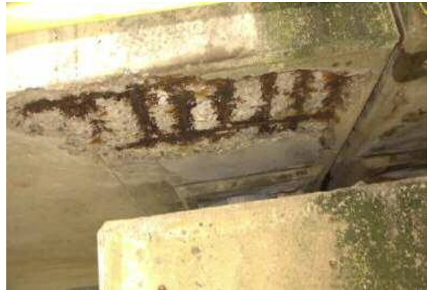
写真-2 けた端部の損傷状況
